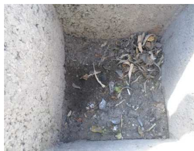
Figure 118 : Evacuation complètement bouchée
