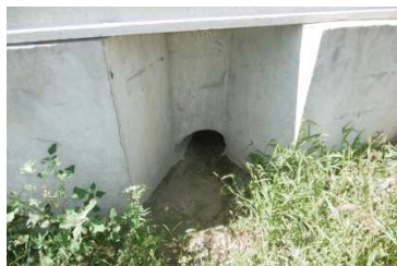
Figure 70 : Arrivée principale du bassin
