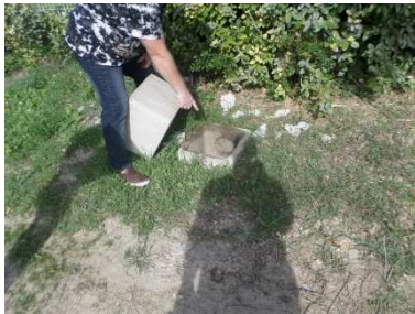
Figure 146 : Trappe de visite - départ du drain débouchant dans le fossé enherbé au Sud (ouvrage O55)
