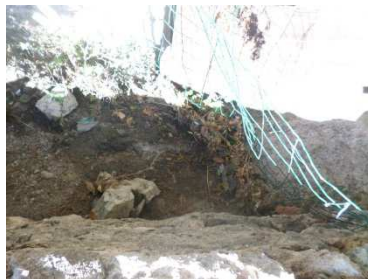
Figure 91 : Fossé de capacité insuffisante
