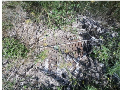
Figure 84 : Traces du débordement du regard de visite sur le réseau d'assainissement, chemin Bas de Saint Georges
