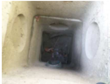
Figure 147 : Trappe de visite - départ du drain débouchant dans le fossé enherbé au Sud (ouvrage O55)
