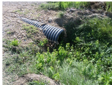
Figure 101 : Buse sous dimensionnée – les eaux pluviales sont passées par-dessus
