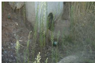
Figure 64 : Arrivée principale du bassin
