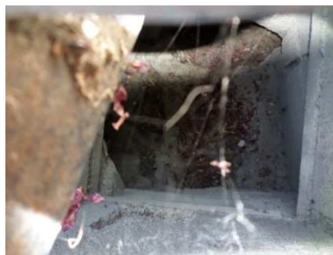
Figure 126 : Débouché de la conduite longeant la limite de propriété entre Laval et Cabrols
