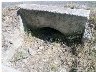
Figure 98 : Ouvrage O42 (partiellement bouché)
