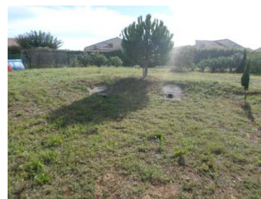
Figure 74 : Vue des 3 buses de sortie du bassin de rétention
