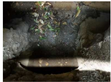
Figure 124 : Conduite longeant la limite de propriété entre Laval et Cabrols
