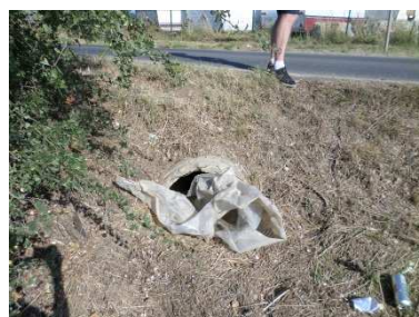
Figure 177 : Débouché de la buse en Ø700, partiellement obstruée (O33)
