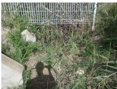
Figure 152 : Fossé non entretenu
