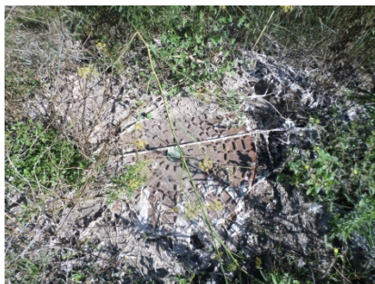
Figure 115 : Traces du débordement du regard de visite sur le réseau d'assainissement, chemin Bas de Saint Georges
