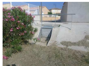
Figure 51 : Exutoire du bassin de rétention
