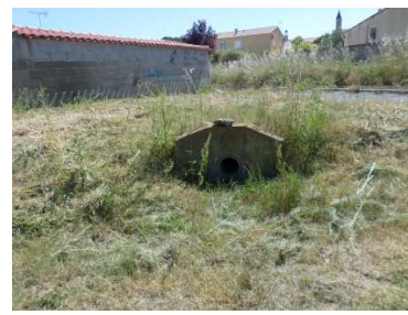
Figure 48 : Exutoire du bassin de rétention
