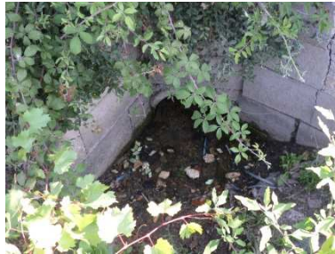
Figure 82 : Arrivée Rejet suspect dans le fossé enherbé
