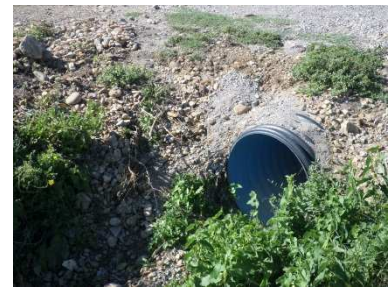
Figure 102 : Buse sous dimensionnée – les eaux pluviales sont passées par-dessus
