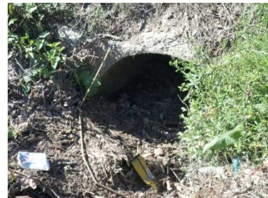
Figure 99 : Débouché de la 2 ème buse dans le fossé enherbé (partiellement bouchée)
