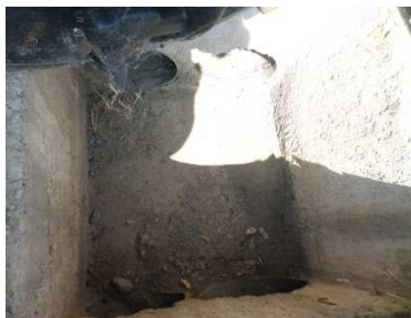
Figure 171 : Débouché des deux sorties du BR dans un réseau enterré
