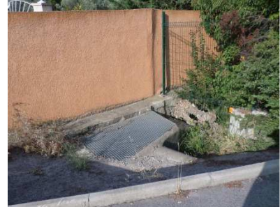
Figure 130 : Exutoire Rue des Cresses (ouvrage O40)
