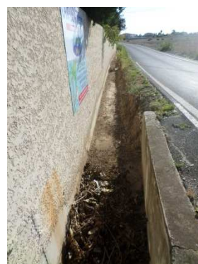
Figure 175 : Fossé bétonné puis fossé enherbé de capacité insuffisante
