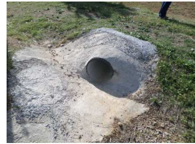
Figure 163 : Débouché de la buse de collecte eaux superficielles
