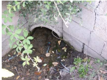
Figure 81 : Rejet suspect dans le fossé enherbé
