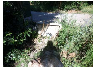
Figure 92 : Buse en Ø300 insuffisante (ouvrage 46)
