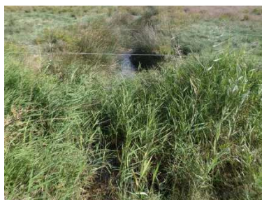
Figure 153 : Fossé non entretenu présentant une contre pente (eau stagnante)
