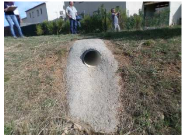
Figure 164 : Débouché de la buse de collecte eaux superficielles
