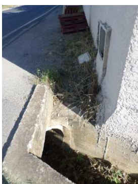
Figure 173 : Débouché de la buse en Ø900 collectant les eaux du rond-point des 4 chemins (O51)
